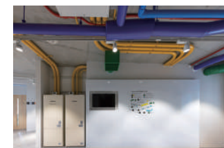
理科室は太陽光での自家発電システムを導入
